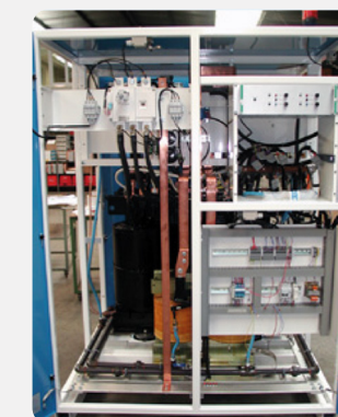
Redresseur pour accélérateur de particules
